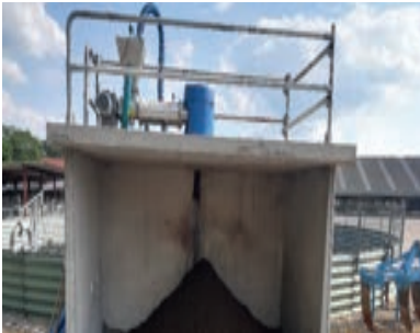
Separation aus Biogas-Anlage
